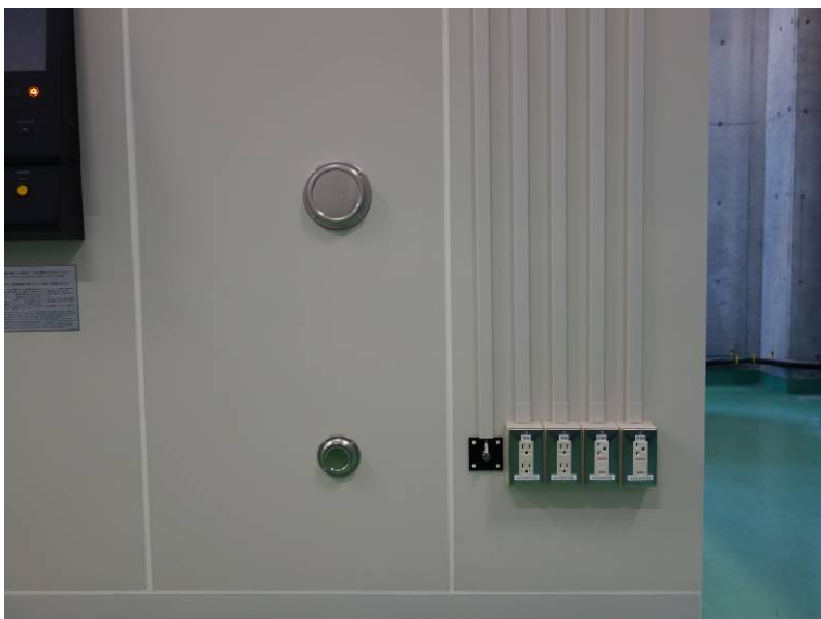
前面(ケーブル孔/コンセント)
